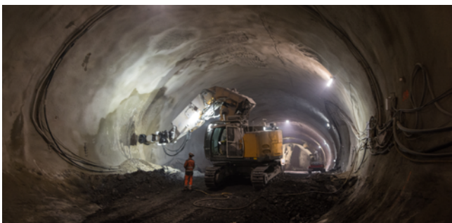
Auch im Tunnelbau kann es zu Expositionen gegenüber Quarzstaub kommen.
