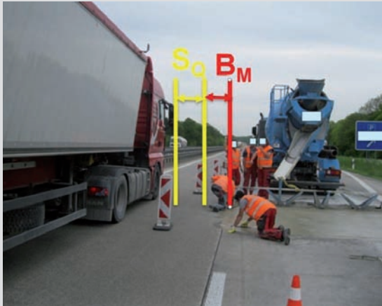
Bild 10: Beschäftigte arbeiten im Grenzbereich zum fließenden Verkehr: ArbStättV und ASR A5.2 müssen angewendet werden
