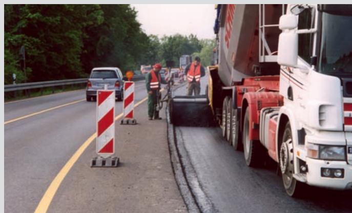
Bild 19: Absicherung durch Baken bei ausreichend freier Bewegungsfläche für den Beschäftigten und ausreichendem Sicherheitsabstand zum vorbeifließenden Verkehr
