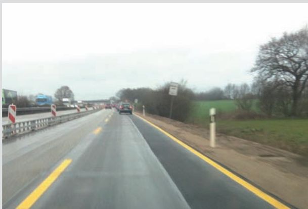
Bild 14: Beispiel für temporäre Fahrstreifenverbreiterung mit dem Ziel, die Zahl der Fahrstreifen während der Bauphase aufrechtzuerhalten
