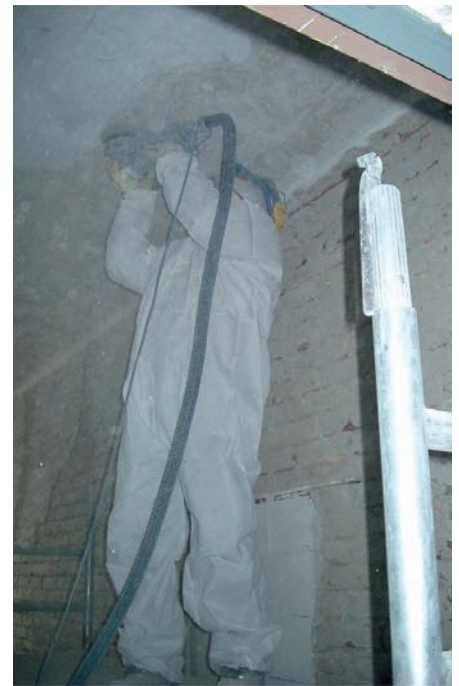
Abb. 7: Hier staubt's! – Entfernen der DDT- haltigen Anstriche und Putze unter schwierigsten Arbeitsbedingungen und zusätzlicher Belastung durch PSA
