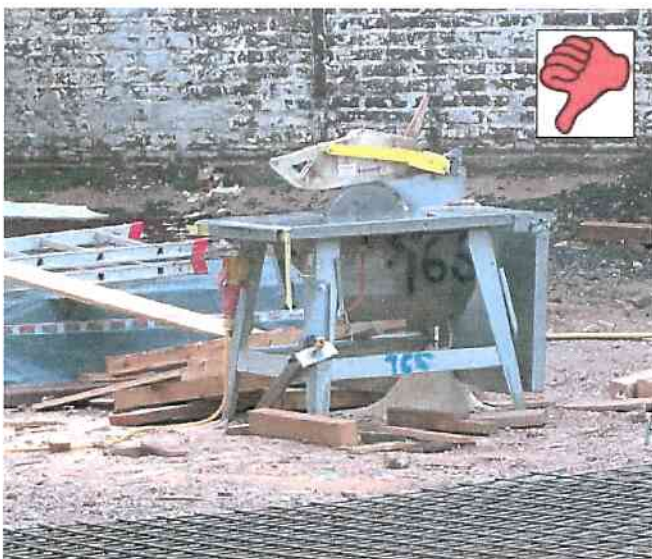
Abb. 6: Manipulation der Sicherheitseinrichtung – Feststellen einer am Spaltkeil befestigten selbsttätig schließenden Schutzhaube (Foto: Opara)
